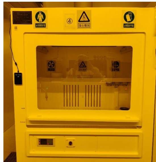
普通化学清洗槽 (1层 4号 显影通风橱)
