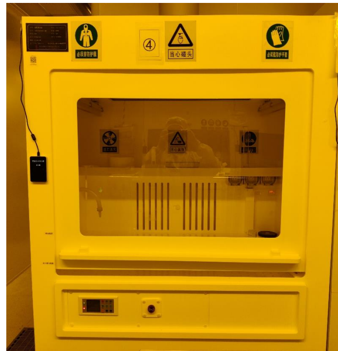
普通化学清洗槽 (1层 4号 显影通风橱)
